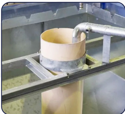
Tubo de entrada de agua sucia.
